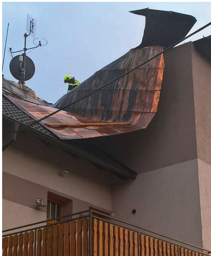
Stržená plechová střecha po orkánu Sabine (foto Hasiči Horní Bříža)
